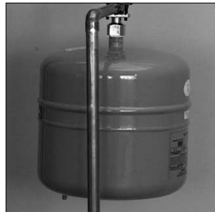
Figure 19 - Le réservoir de dilatation thermique devrait être pressurisé avec de l'air, pour correspondre à la pression d'entrée d'eau du domicile.
