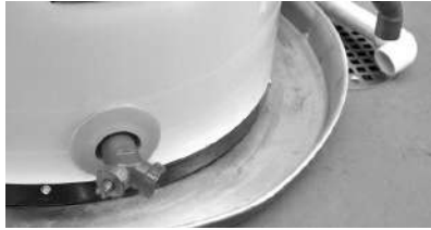
Figure 8 - Un bac de vidange approprié canalisé à un drain adéquat peut aider à protéger le plancher des fuites et des égouttements.
