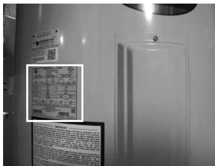
Figure 22 - Les exigences électriques du chauffe-eau peuvent être déterminées à partir de la plaque signalétique.
