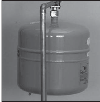
Figure 16 - Le vase d'expansion thermique devrait être pressurisé avec de l'air, pour correspondre à la pression d'entrée d'eau du domicile.
